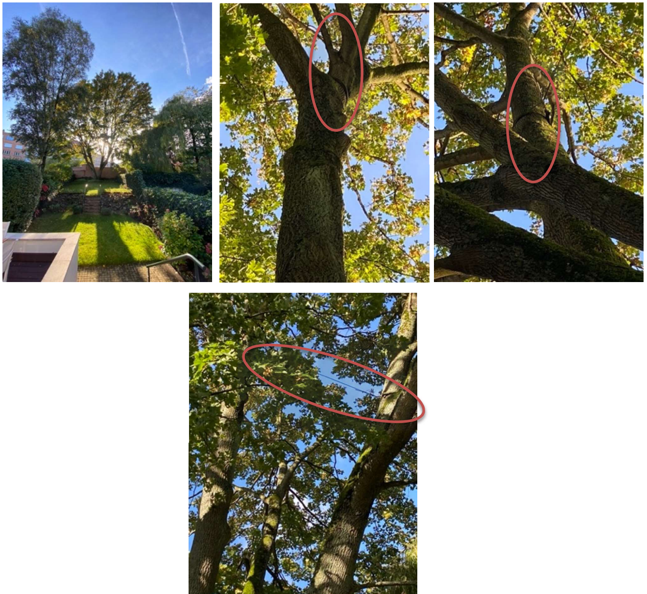
Figure 4: vue d'ensemble de la couronne de l'arbre et de ses charpentières avec les haubans
